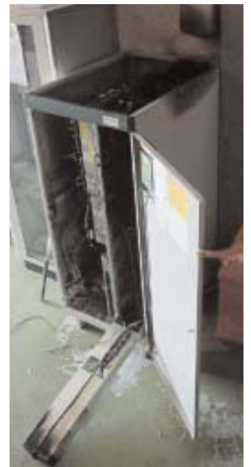
Im HIL brannte eine Elektroanlage aus.
